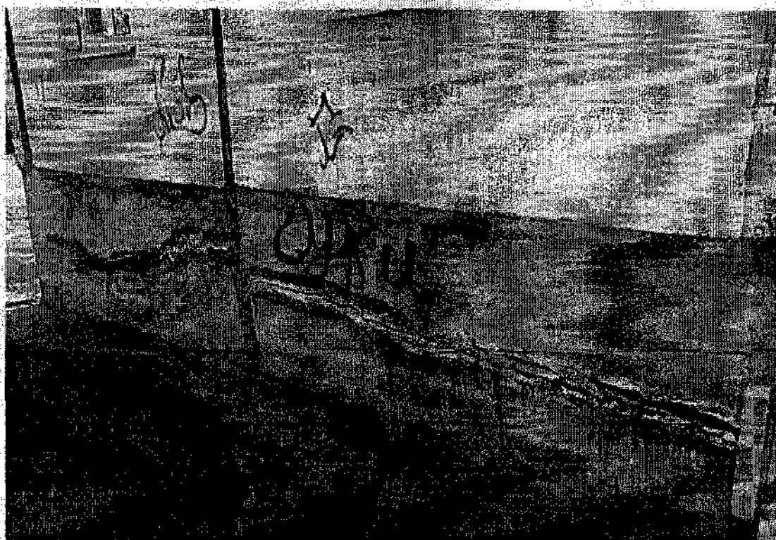
Фото Б6. Разрушение облицовочных ж/б панелей на уровне полуподвала.
